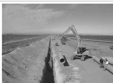
Acueducto Trelew- Madryn
