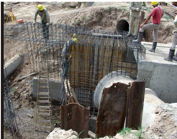
Estación de bombeo - Salida de desagües pluviales
